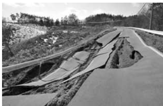
地震で崩壊した江刺区の道路
