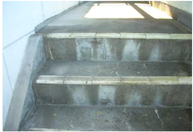
外部階段：モルタルの劣化
