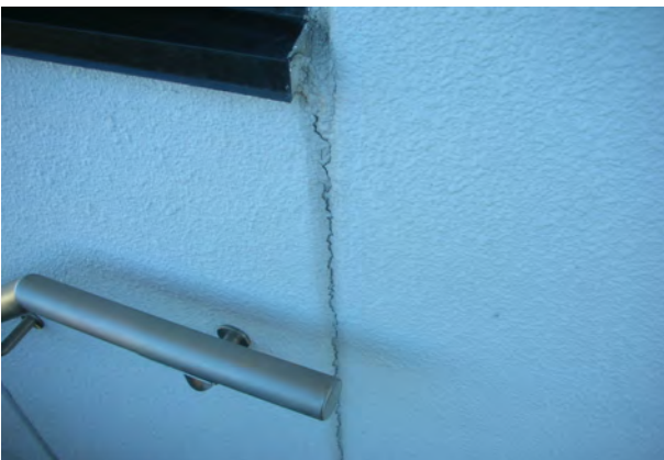
外壁：ALC版の目地部のひび割れ
