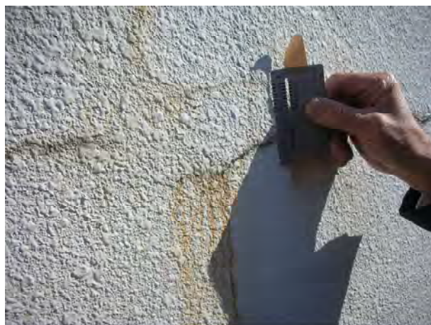
外壁：ひび割れにより劣化が進行し、鉄筋の錆汁が露出
