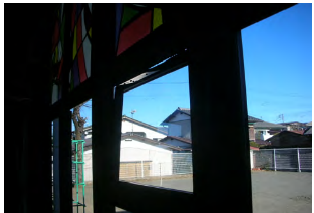
遊戯室：一部サッシが故障により開閉不良
