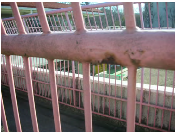
屋上手すり：腐食が進行
