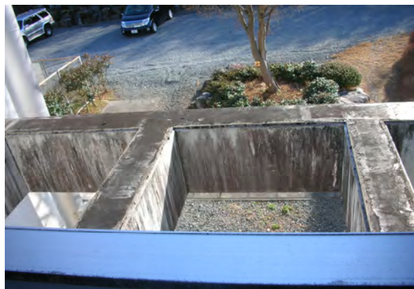
テラス上部の梁型：汚れが目立つ
