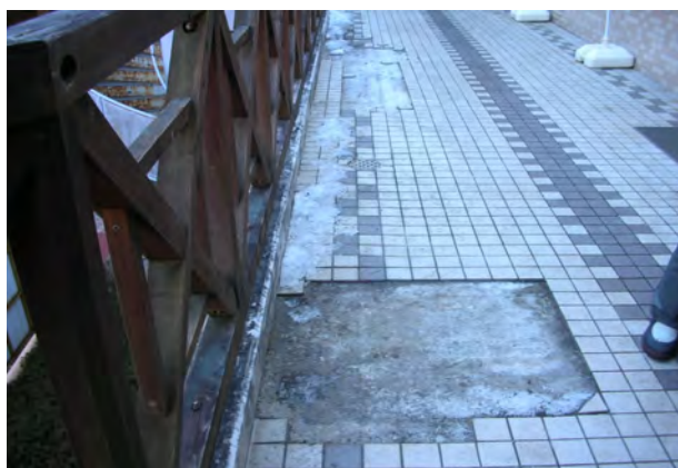
外部デッキ：凍害により、床タイルが剥離
