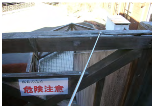
外部手すり：木部腐食が進行し危険な状況
