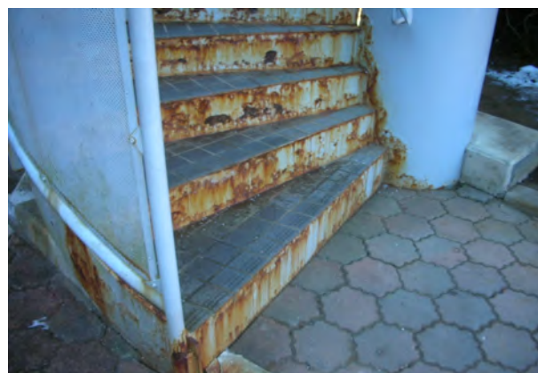
外部階段：腐食が進行
