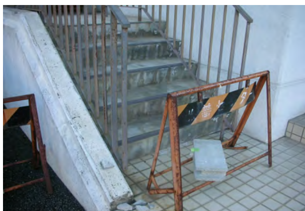
外部階段：北側にあり、凍害等影響を受けやすく、劣化が進行している
