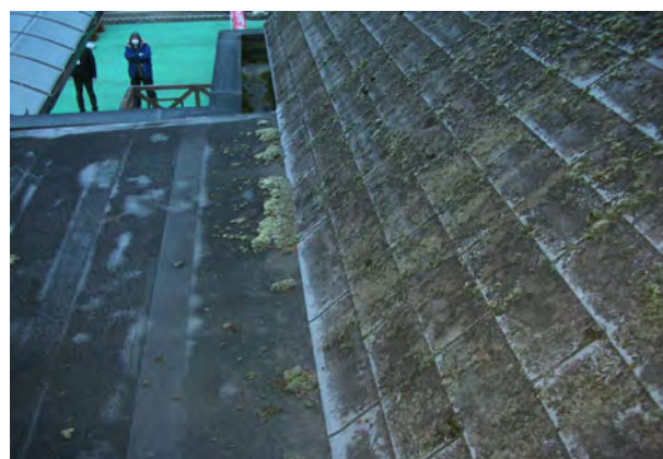
屋根：苔が繁殖し、劣化が進行
