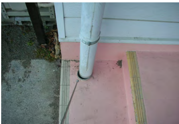
テラス：雨樋とテラスの接続部がはずれている
