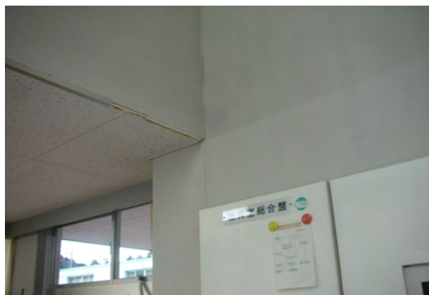
職員室：天井と壁の見切が一部脱落
