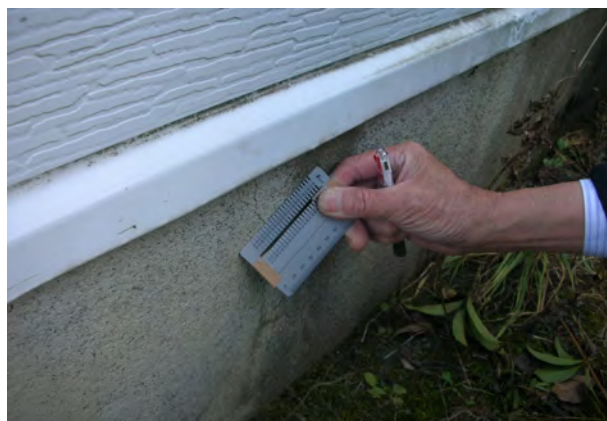
基礎：基礎立上りのひび割れ測定
