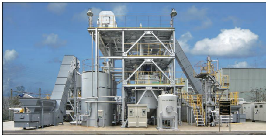
図表 5- 1 都市油田発掘プロジェクトのプラント全景
