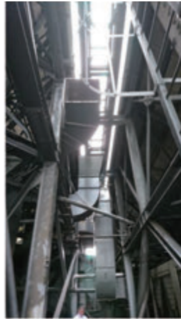
上部と側面に換気の隙間があるが換気が十分でなく、熱溜りとなっている
