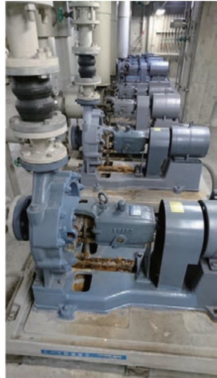
冷温水ポンプの錆
