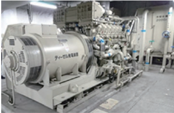
自家発電設備
