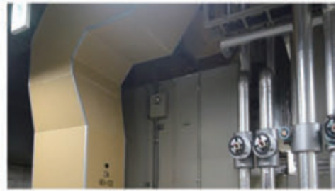
外気の取込み (自然外気が取り込めていない)
