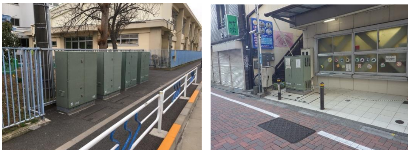
図 4-28 公共用地等への地上機器設置事例
