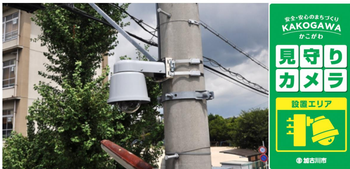
図表2 見守りカメラ全景写真及び設置表示看板
