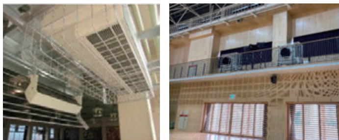
災害時にも利用可能な学校体育館の空調設備
