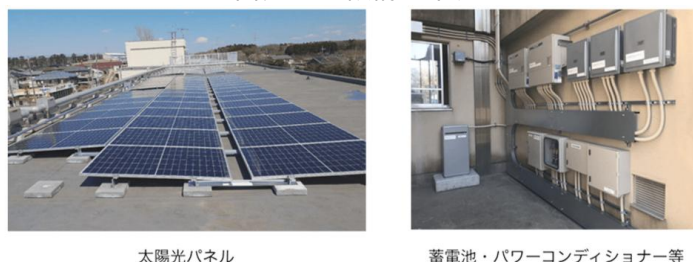
太陽光パネル
