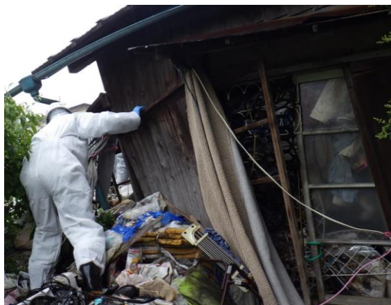
建物内への侵入が不可能な状況
